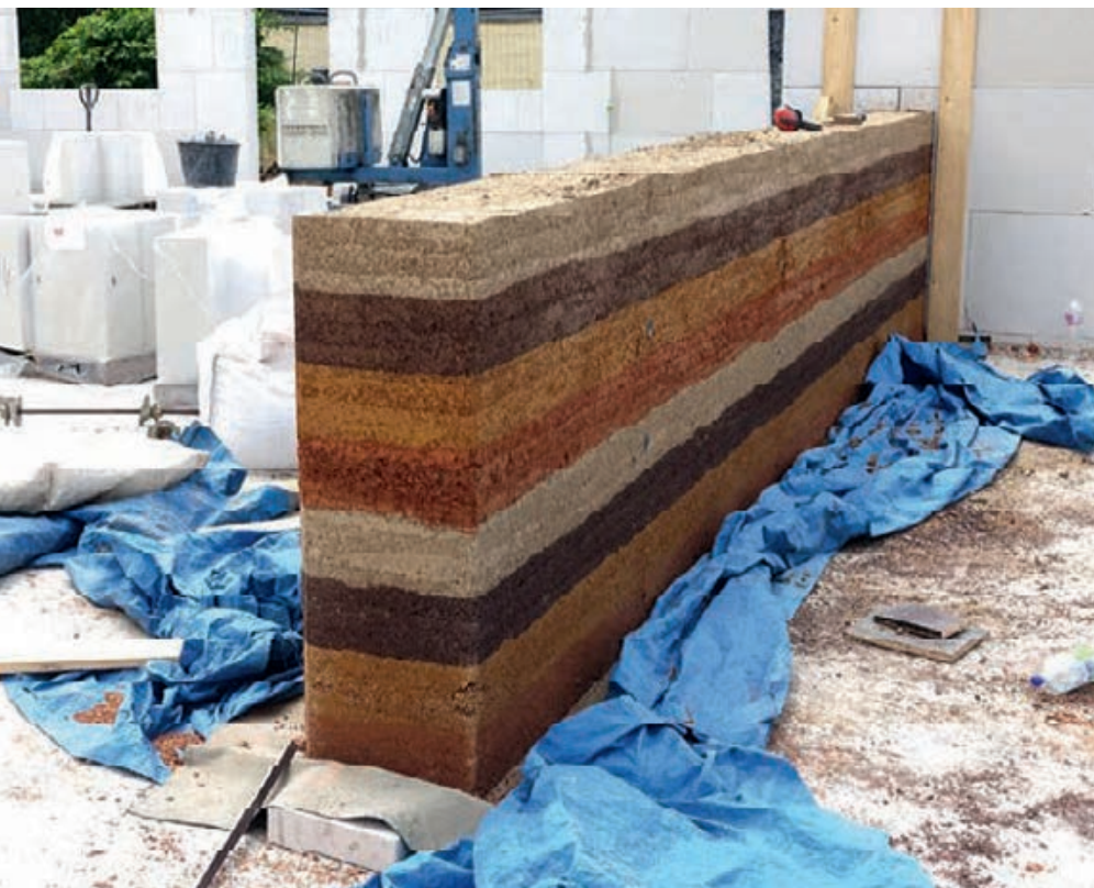
Die interessante Materialität und Ästhetik der Wand kamen bereits beim Bau heraus. Lehm als traditioneller haptischer Baustoff trägt zum guten Raumklima in der Schule bei
