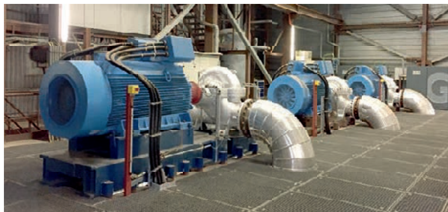
Heizwerk Wilhelminenspital: Die Netzpumpen leisten je 1.100 Kilowatt
