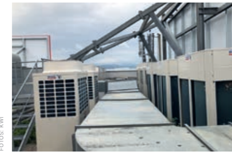
← Die sechs Klima-Außeneinheiten fanden auf dem Dach ihren Platz
