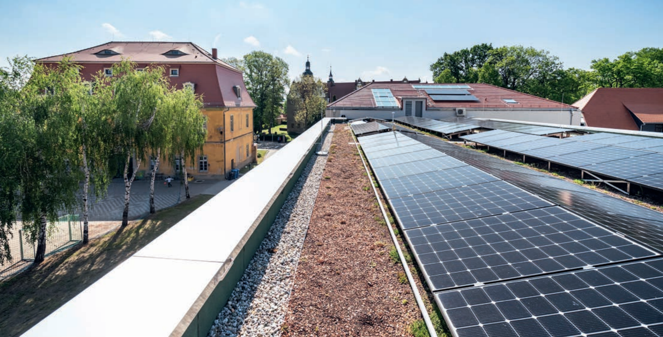
↑ Die Fotovoltaikanlage auf dem Gründach hilft beim Erreichen der Nullenergiehaus-Vorgaben
