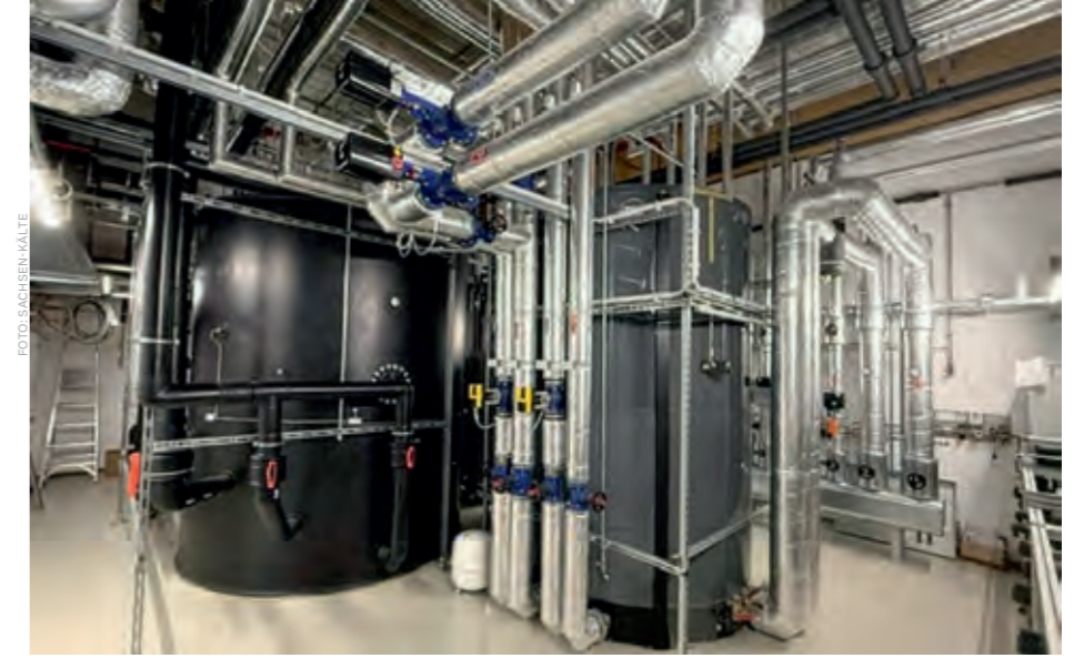
↑ Flüssigeis wird in einem zwölf Kubikmeter großen Eisspeicher gelagert.
