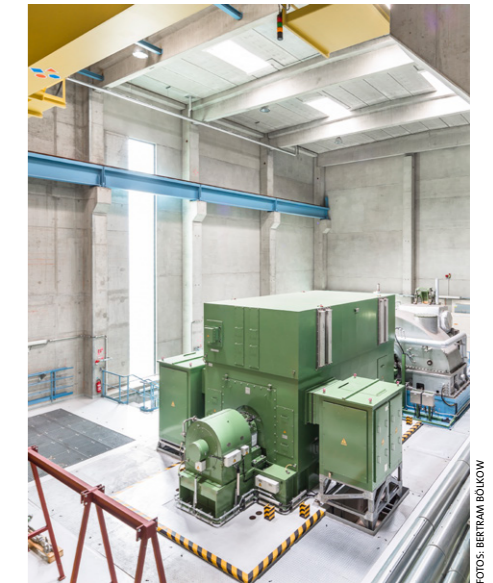
Maschinenhaus mit Generator und Turbine
