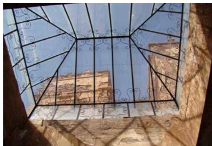
Konstruktiver Schutz traditioneller Lehmbauten gegen Starkniederschläge (Kasbha in Telouët, Atlas)
