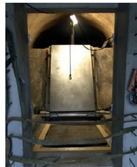
Verschlussklappen dienen als Sicherung bei Rohrbruch
